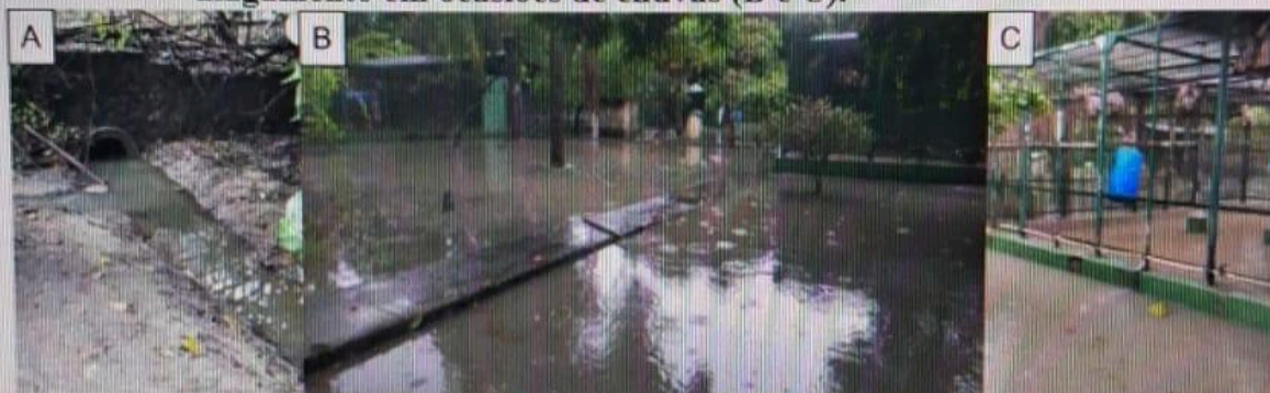
Figura 15 – Imagens do sistema de drenagem da colônia macacos rhesus (A) e alagamento em ocasiões de chuvas (B e C).
