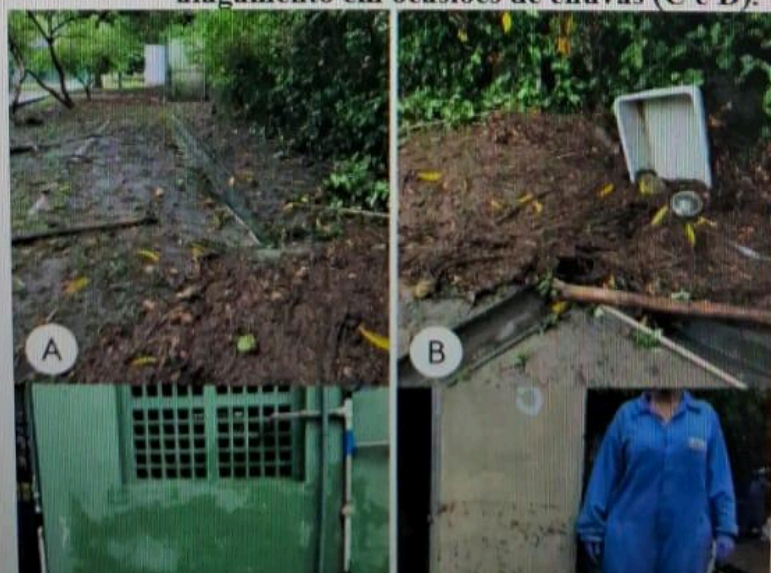
Figura 16 – Imagens do sistema de drenagem da colônia macaco rhesus manutenção (A e B) e alagamento em ocasiões de chuvas (C e D).
