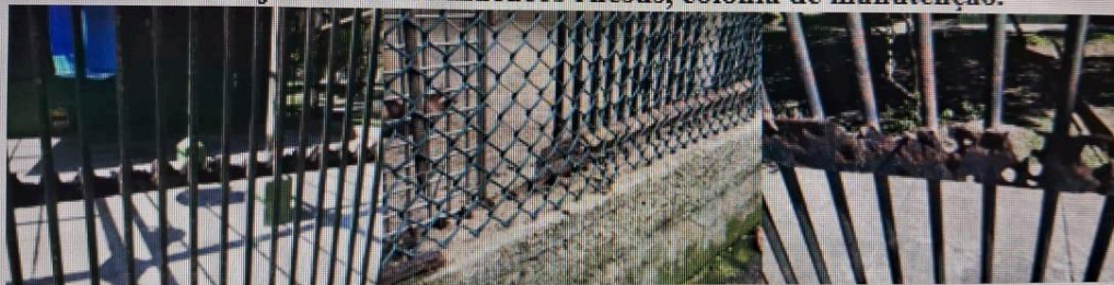
Figura 14 – Imagens do estado de degradação das grades dos recintos destinados ao alojamento dos macacos rhesus, colônia de manutenção.
